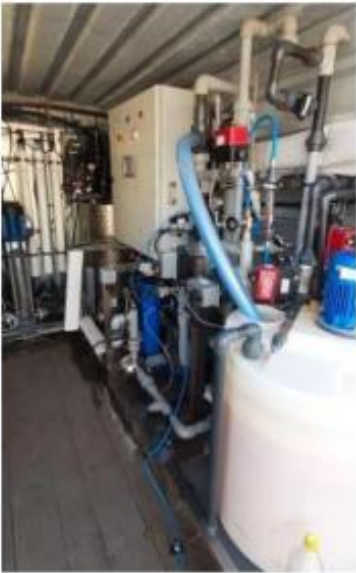
Figure 3 : Intérieur du container - carters d'ultrafiltration
