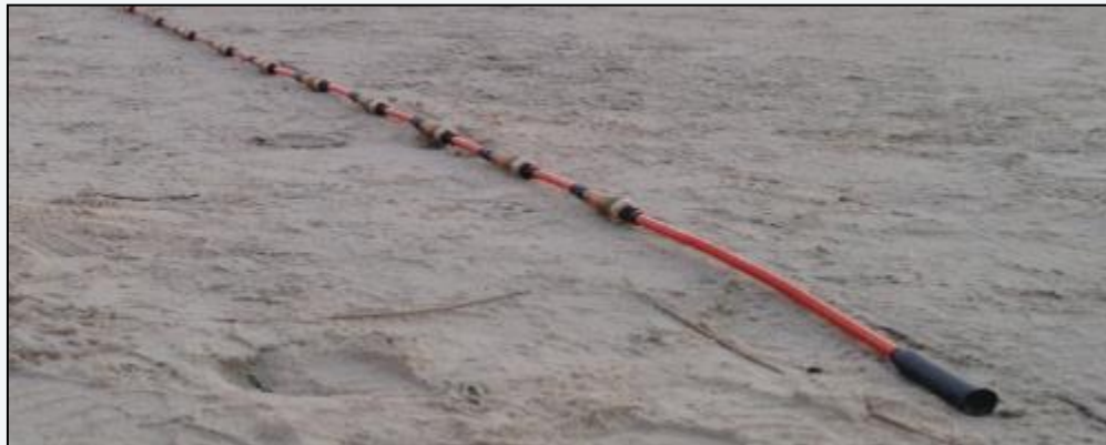
Câble électrique installé dans le piézomètre
