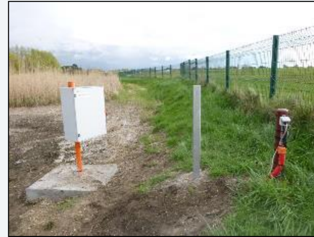
Installation avec fourniture d'électricité
