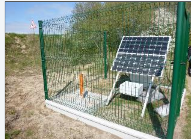
Installation autonome avec panneaux solaires
