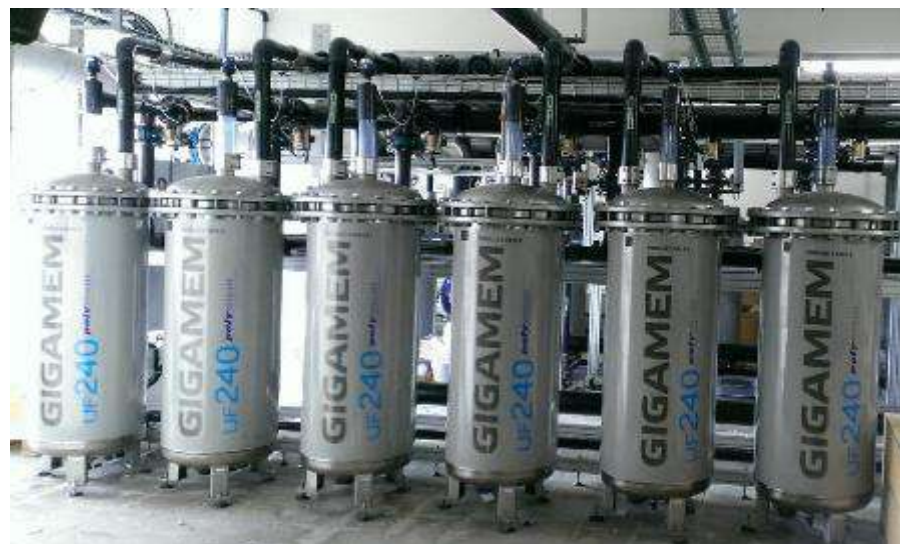
Production d'eau potable
